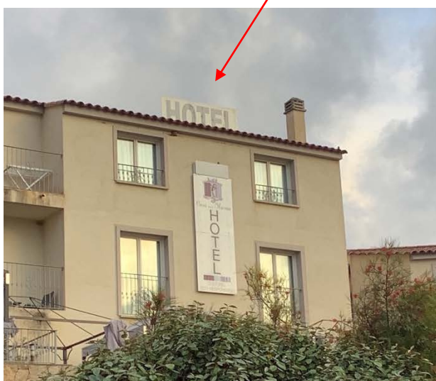
Enseigne sur toiture Serra-di-Ferro / Sarra di farru, juin 2024.
